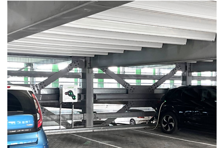
Abb. 29 E-Ladeboxen in einem Parkhaus in Dreieich
