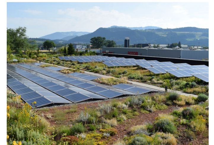
Abb. 25 Dachflächen-Photovoltaik (Bundesverband Gebäudegrün, 2023)
